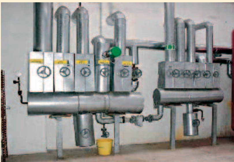
Vorbildliche Wärmedämmung an Leitungen und Armaturen des Warmwassernetzes
